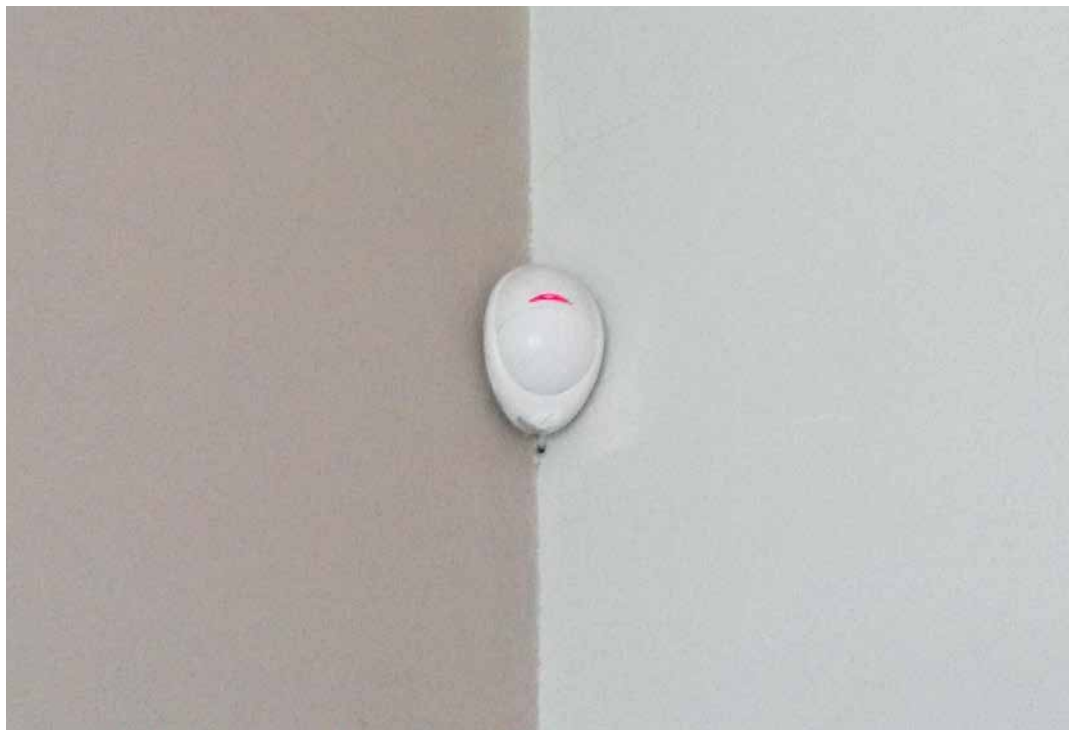
Czujnik ruchu zainstalowany w narożu pomieszczenia
